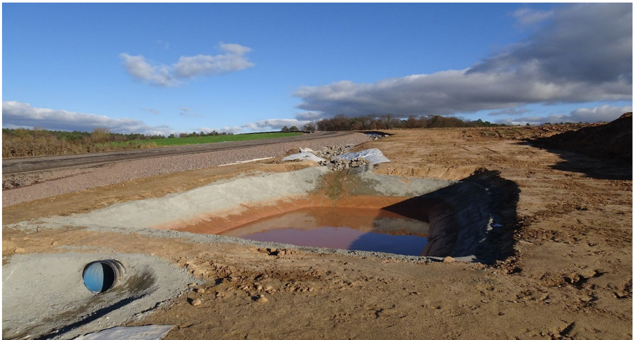
Abbildung 6: Temporäres Absetzbecken (Aufnahme vom 22.11.21).
