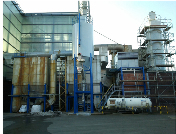
Abbildung 21: Dreistufige Gewebefilteranlage mit Eindüsung von \text{Ca}(\text{OH})_2 zur Emissionsbegrenzung von Fluorwasserstoff. © RP Gießen
