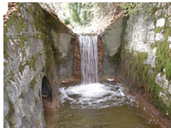
Uferverbau mit hohem Absturz
