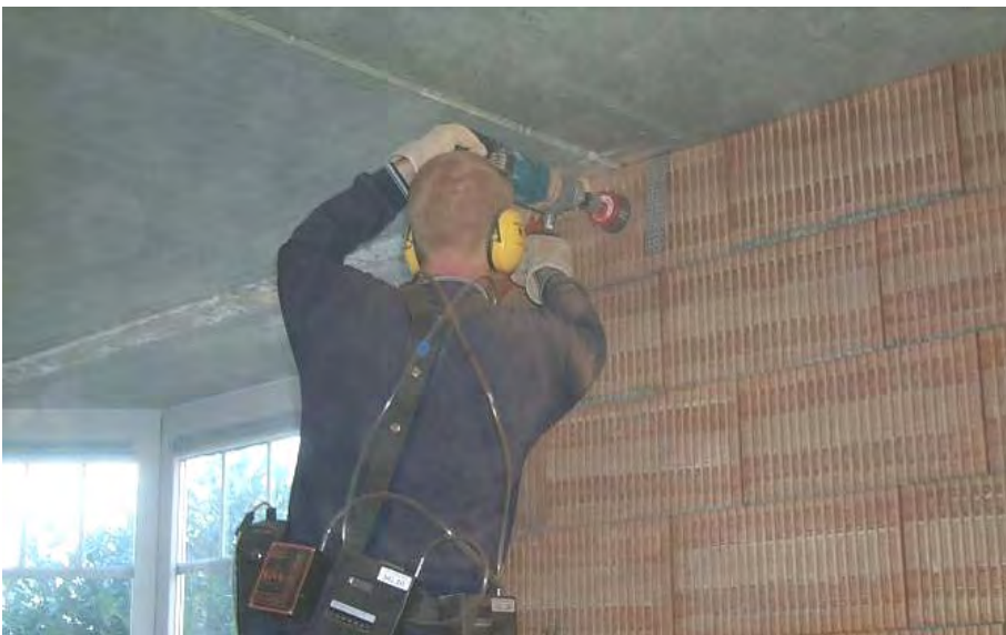
Bild 10: Dosensenken ohne Absaugung in einem Rohbau
